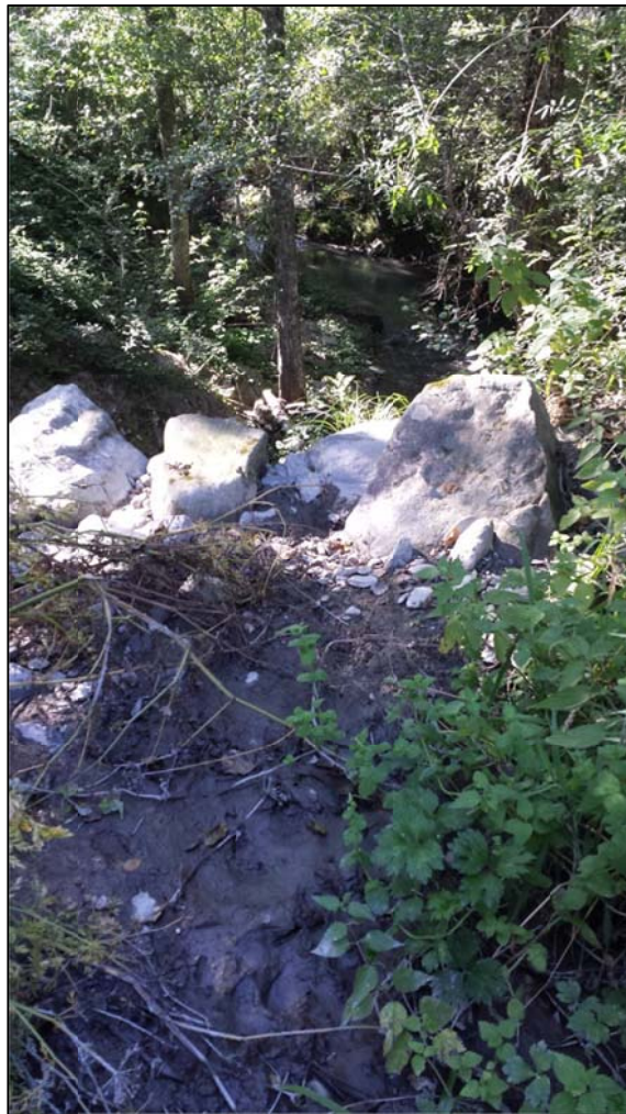
Fotografía 7: Detalle de la acumulación de sedimentos en "A Armada".
