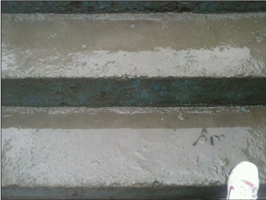
Fotografía 9: Restos de los sedimentos depositados en la zona.
