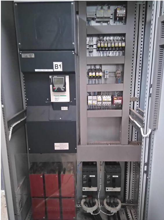
Foto 9 – Cadro eléctrico das bombas
