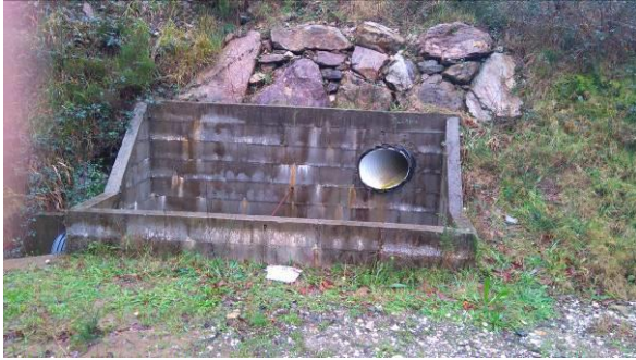
Foto 7 – Arqueta de desaugue das bombas de achique de Pozo Nuevo. Dende aquí canalizaranse as augas en canalización de PVC ata a zona da pranta de lavado para o seu tratamento
