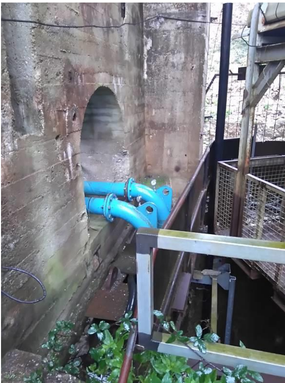
Foto 5 – Tubaxes do bombeo de achique de Pozo Nuevo
