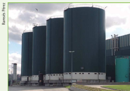
Tanques dixestores na planta de Nostián.
