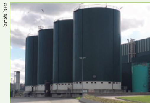
Tanques dixestores na planta de Nostián.
