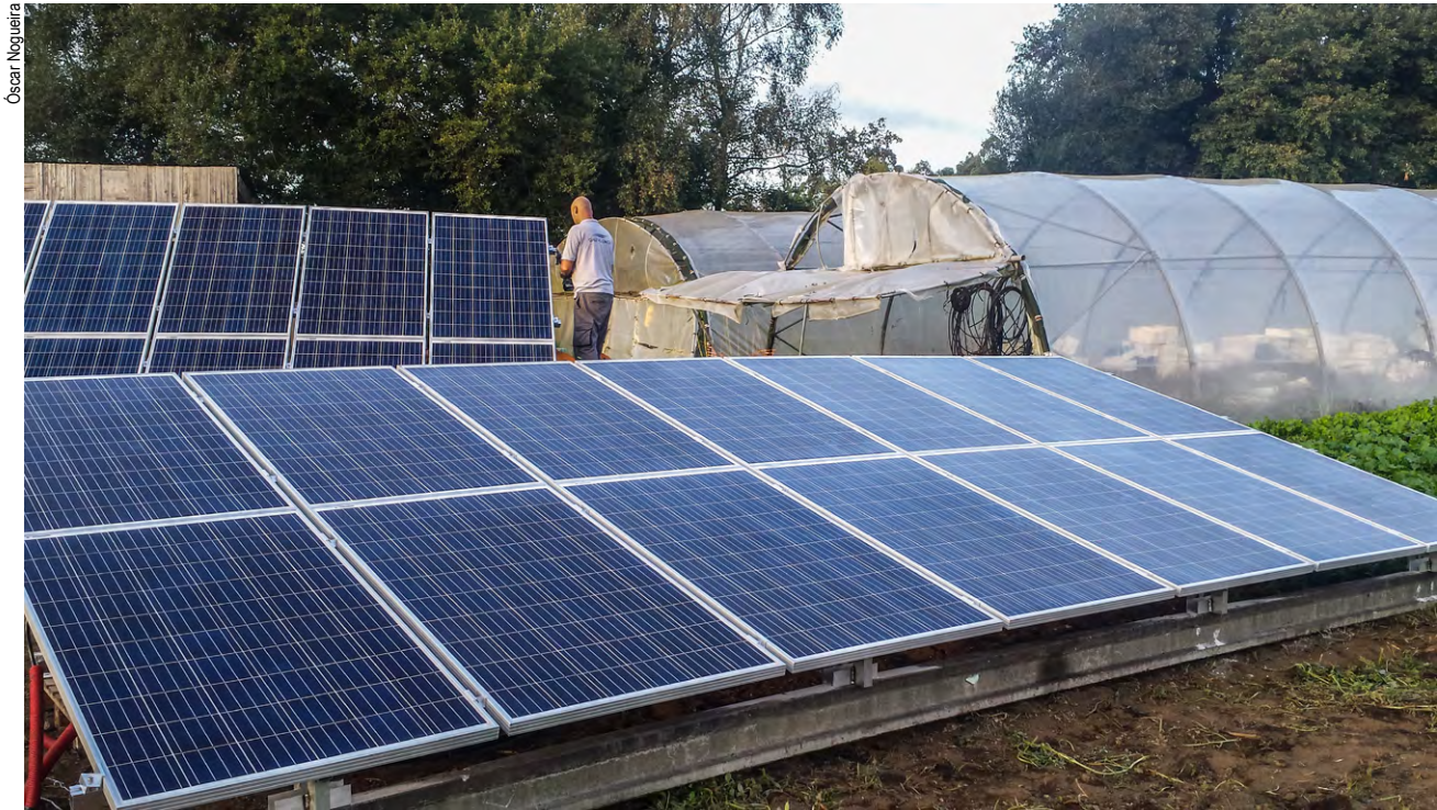
Autoconsumo fotovoltaico en explotación agropecuaria en Teixeira (Curtis).
