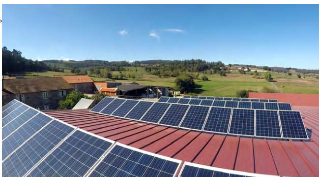
Instalación fotovoltaica para autoconsumo enerxético en explotación leiteira na Baña.
