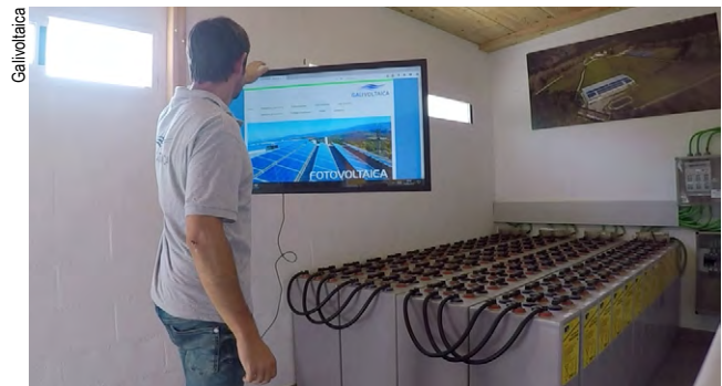
Sistema de baterías de xel en instalación fotovoltaica illada no rural.
