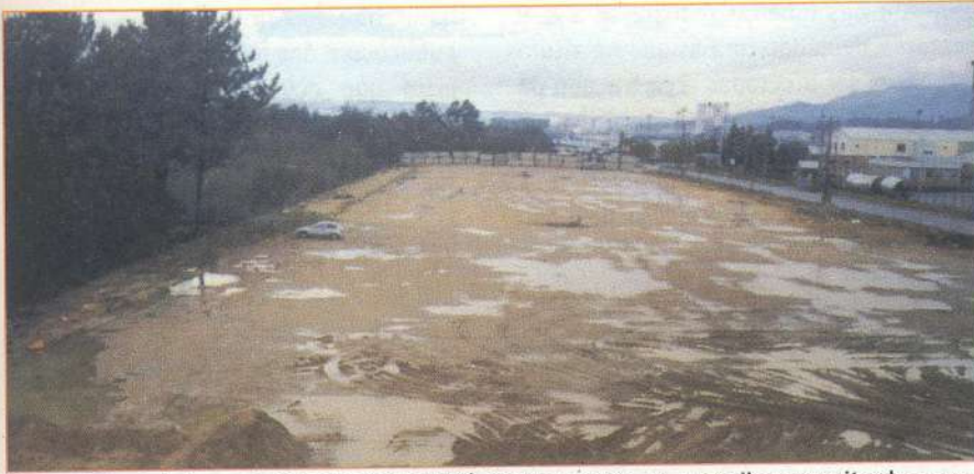
Aterro a carom da lagoa de Orbenhe (ano 2004). Neste ano esta-se a ampliar aproveitando a construçom dumha nave industrial
