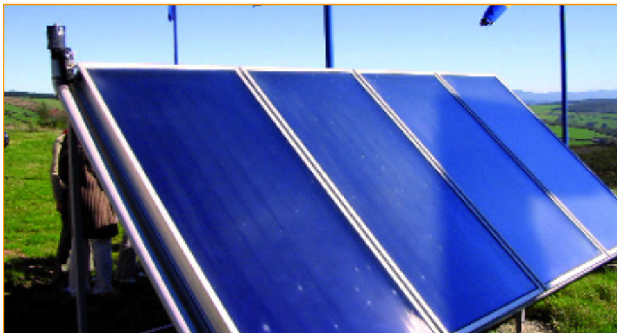
Placas solares térmicas en Sotavento
