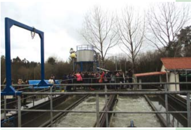
Visitas á ETAP-EDAR de Carballo (marzo 2015). É unha colaboración de ADEGA co Concello de Carballo, dentro do "Proxecto Anllóns-Bardoso: posta en valor dos ríos", co obxectivo de sensibilizar aos escolares sobre os usos da auga. As visitas guiadas por educadores/as ambientais de ADEGA buscan o aforro no consumo de auga.
