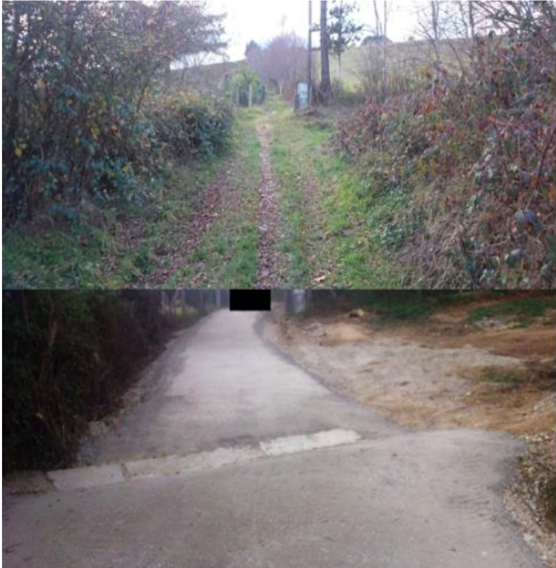
Imagen comparativa del antes y el después de las obras de Turismo en un tramo del Camino Primitivo.
